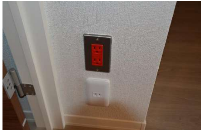
非常用コンセント
